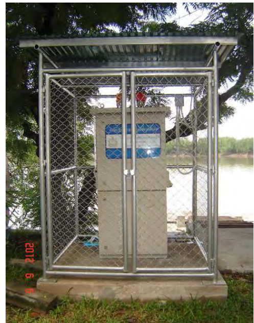
สถานีตรวจวัดคุณภาพน้ำอัตโนมัติ ณ บริเวณโรงพยาบาลส่งเสริมสุขภาพตำบลบางกรูด อำเภอบ้านโพธิ์ จังหวัดฉะเชิงเทรา
